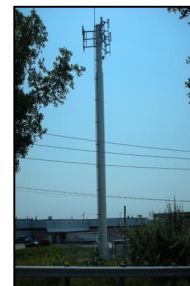
Tour de télécommunication (photo GGBB)
