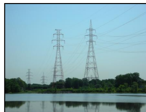
Ligne hydro-électrique (photo GGBB)
