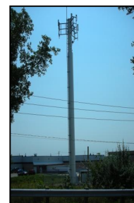
Tour de télécommunication (photo GGBB)
